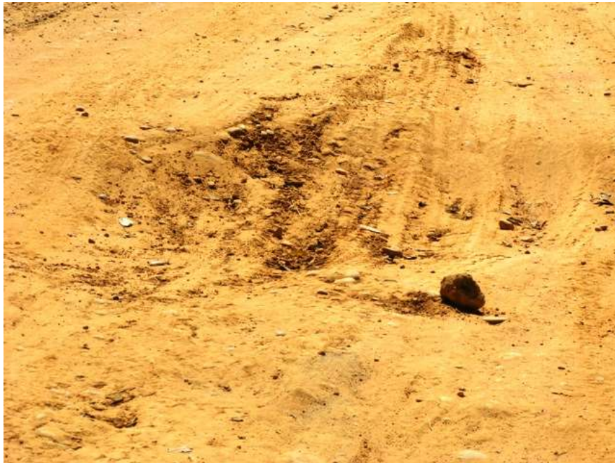
FIGURA 7: Buracos ou Panelas Fonte: Autora (2010)
