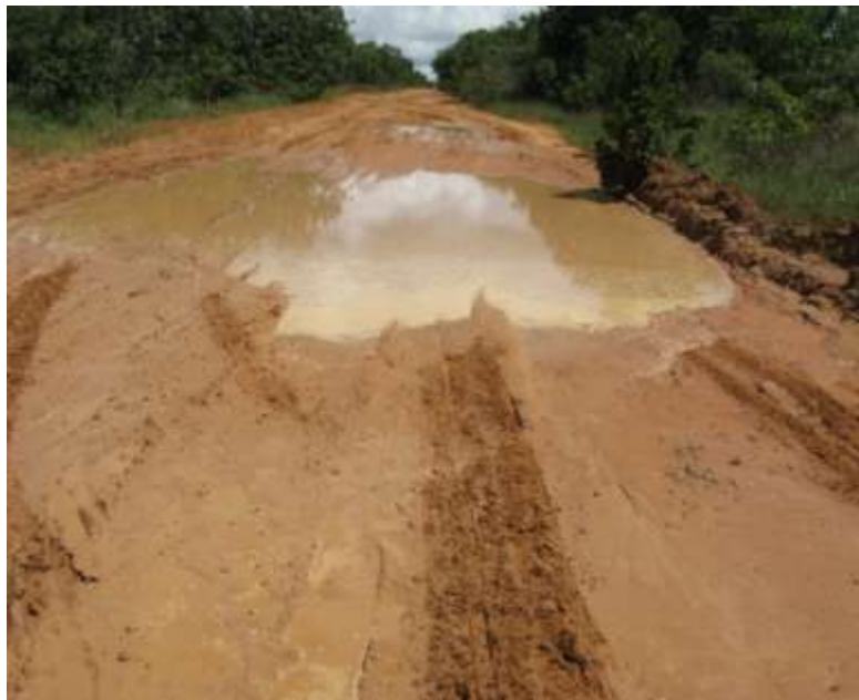
FIGURA 8:– Buracos ou Panelas Fonte: Autora (2010)
