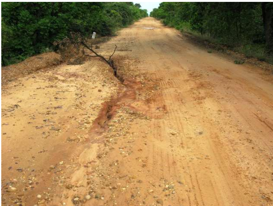
FIGURA 8:– Buracos ou Panelas Fonte: Autora (2010)
