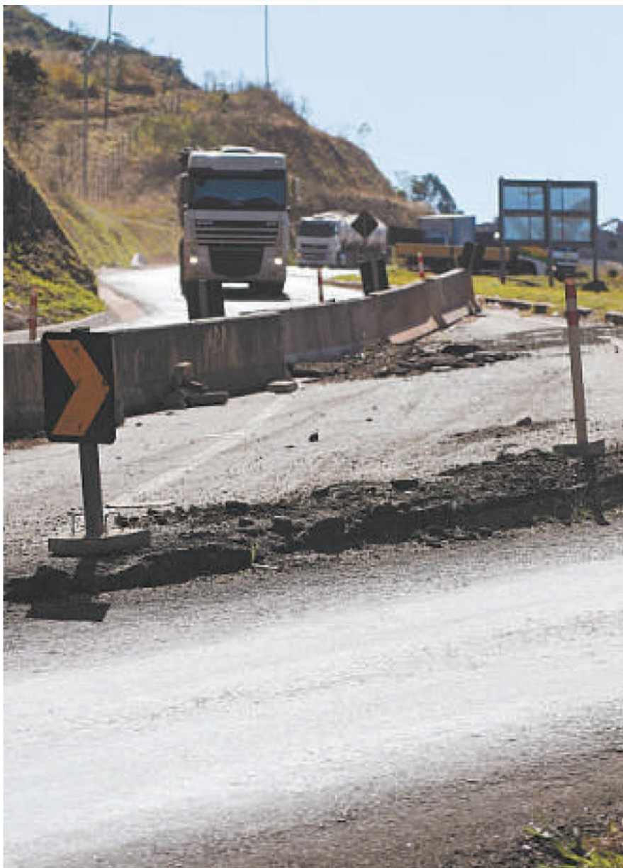
Perto de Caeté, trecho crítico da 381 aguarda adequações, enquanto rodovias 262 e 040 enfrentam problemas com concessionários
