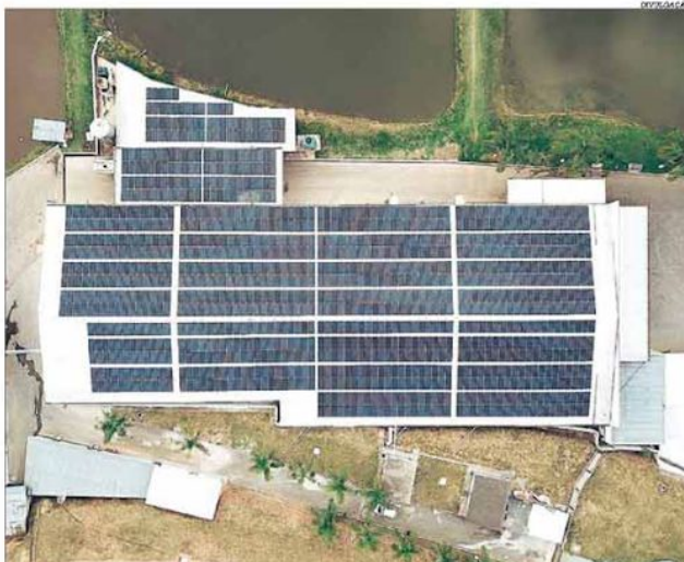
O Grupo Curral de Minas investiu R$ 2 milhões para instalar 3 usinas de energia solar em Oliveira
