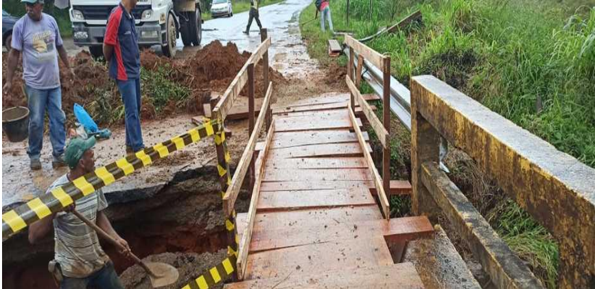
DER-MG e prefeitura de Santa Bárbara do Tugúrio construíram uma passarela de pedestres no local
